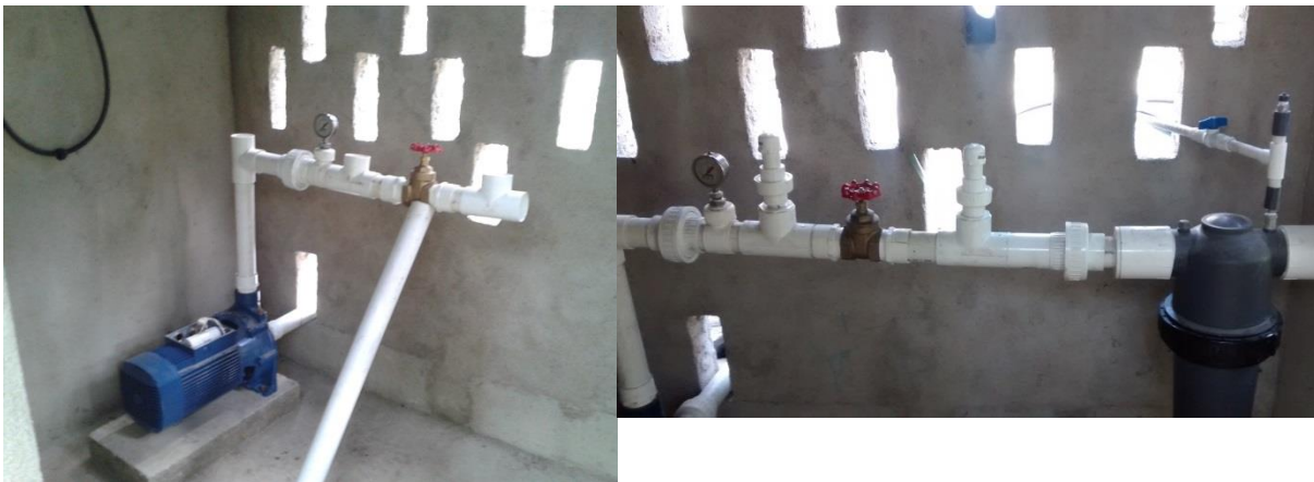
Imagen 16. Instalación de bombeo
