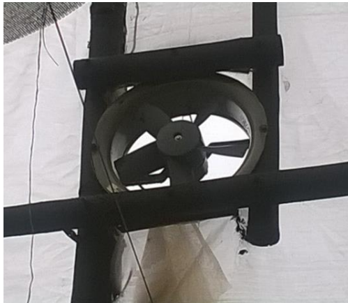
Figura 9. Extractor del invernadero
