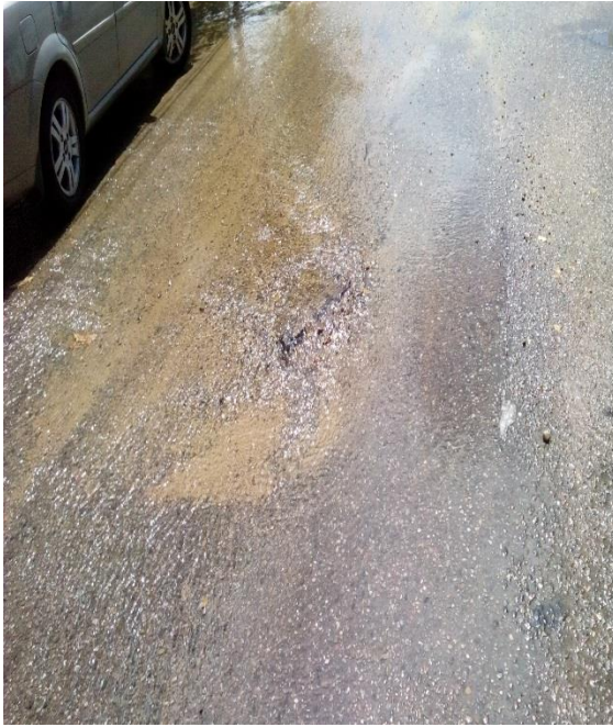
Imagen No 2: Afloramamiento de la fuga
