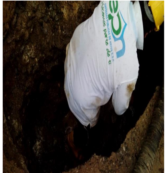
Imagen No 5: Ubicación de la fuga
