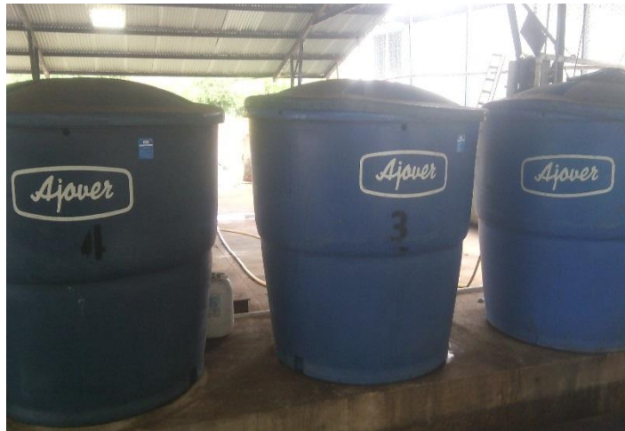
Figura 9. Tanque de 2000 lt
