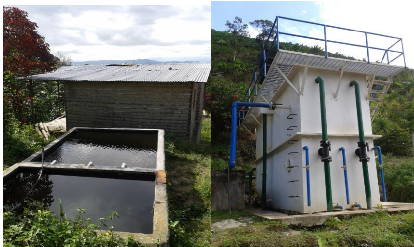
Figura 6. Sistemas de captación y almacenamiento de agua presentes en la microcuenca
