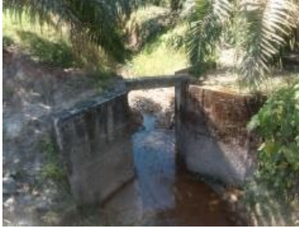
Figura 12. Erosión del solado en época de riego
