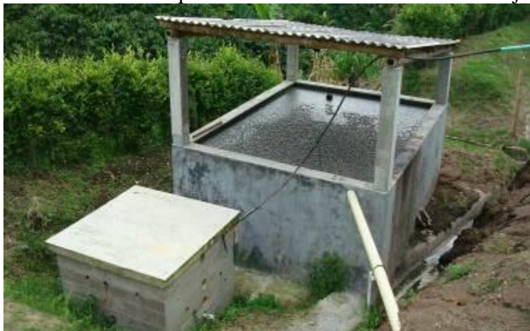
Ilustración 9. Tanque de almacenamiento con cubierta fija.
