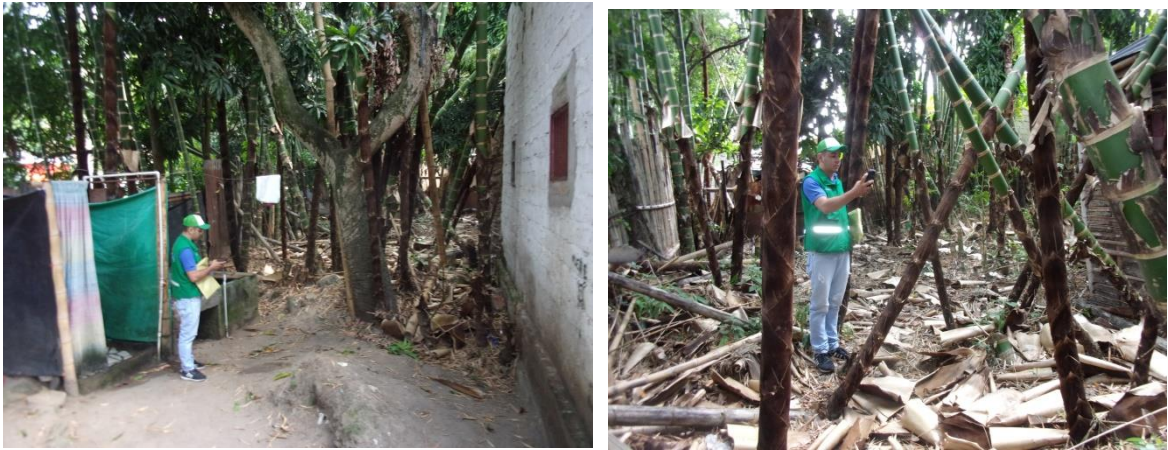
Ilustración 17: Medida Preventiva de Seguimiento tala de guadua, barrio el jardín quebrada la Cascajosa.
