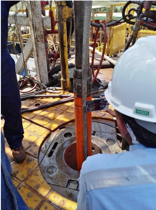
Figura 77. Piso de trabajo con parrilla antideslizante
