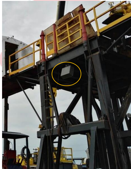
Figura 79. Lámparas antiexplosion en la subestructura
