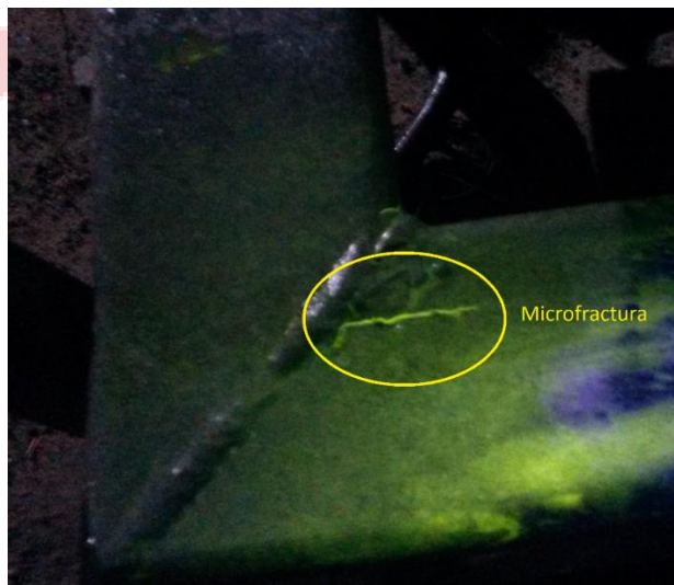
Figura 43. Microfracturas identificadas por medio de luz negra. Fuente: S.I (Servicios de Inspección)
