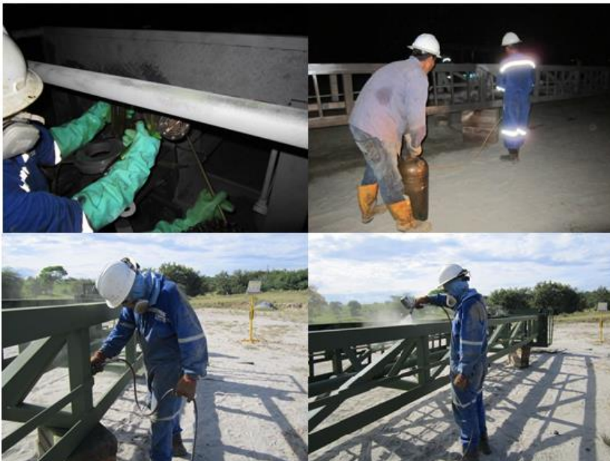
Figura 41. . Proceso de aplicar campos magnéticos por medio de yoke donde se aplican las partículas magnéticas Fuente: S.I (Servicios de Inspección)
