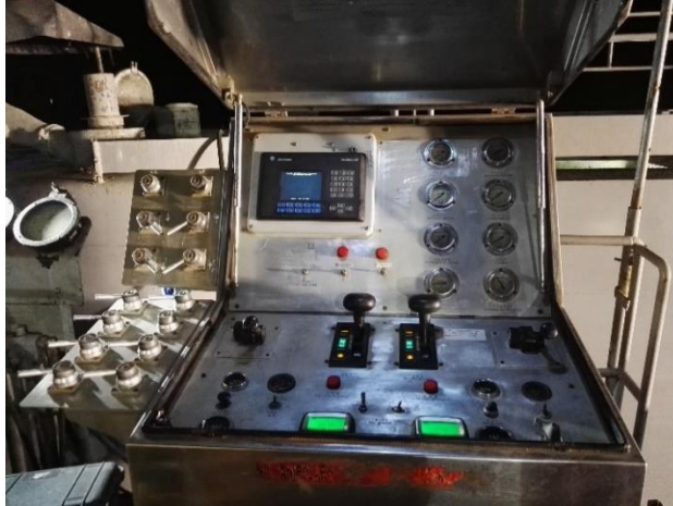
Figura 84. Consola del choke y controles de la BOP.
