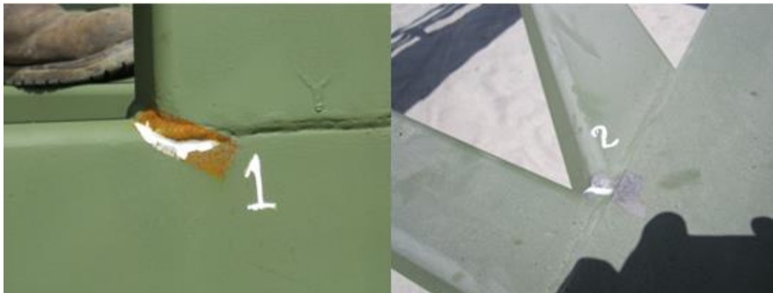
Figura 48. Pegues de soldadura con fisuras. Fuente: S.I (Servicios de Inspección)
