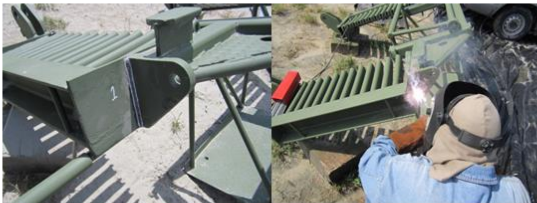
Figura 53. Pegue de la soldadura con fisura en el Trabajadero de varilla y reparación de esta por medio de soldadura Welduct, Norma ASW/ ASME – SFA-5.5 y clasificación Megriwell E-9018 G, electrodo 1/8. Fuente: S.I (Servicios de Inspección)
