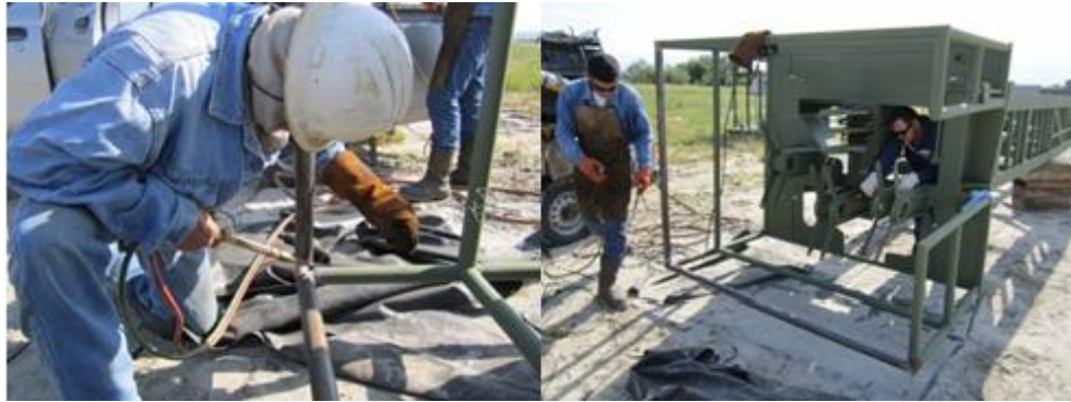
Figura 56. Inspección al bloque de corona. Fuente: S.I (Servicios de Inspección)
