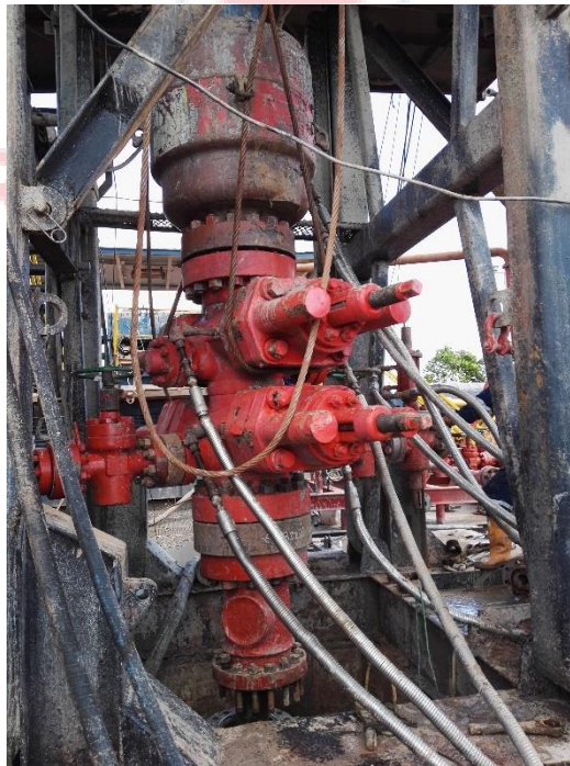
Figura 85. Conexiones de cableado hidráulico y eléctrico al BOP.
