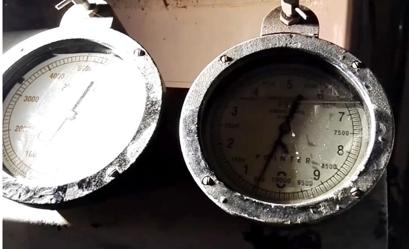
Figura 82. Manómetros de los controles de la consola del choke.
