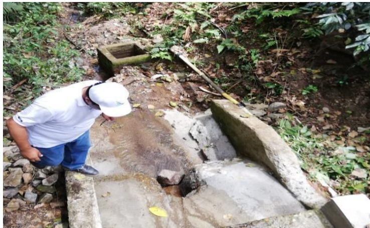
Fotografía 4-5 Tubería de aducción expuesta
