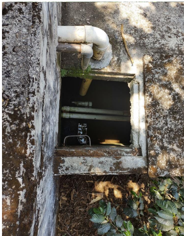
Fotografía 4-9 Salida Tanque Almacenamiento
