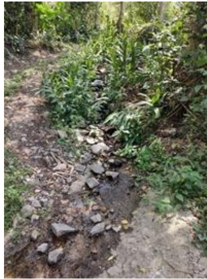
Fotografía 4-2 Filtraciones por alteraciones de la tubería
