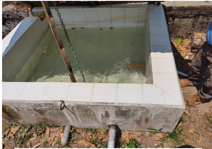
Fotografía 4-8 Tanques de almacenamiento
