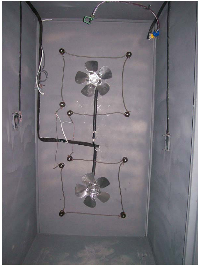
Fig. 21 Sistema de ventilación forzada
