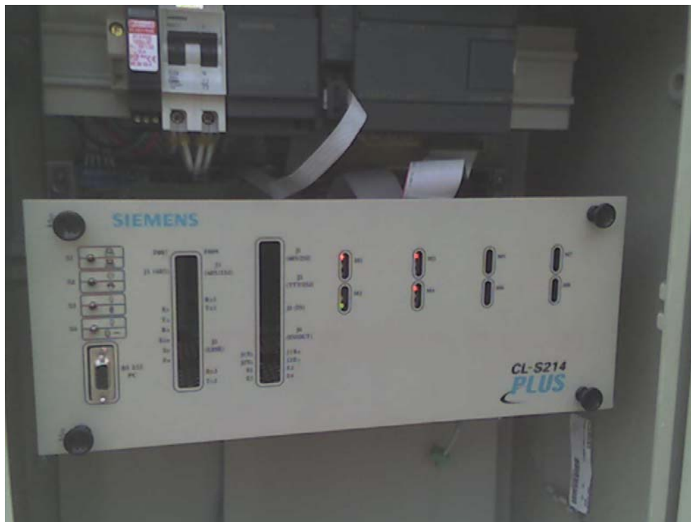
Figura 10. Controlador de semáforos SIEMENS
