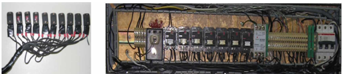
Figura 15. Sistema eléctrico anterior del EDP.
