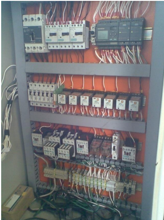
FIGURA 9. Equipos de control U.T.L 1
