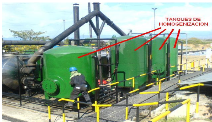
FIGURA 3. Tanques de homogenización
