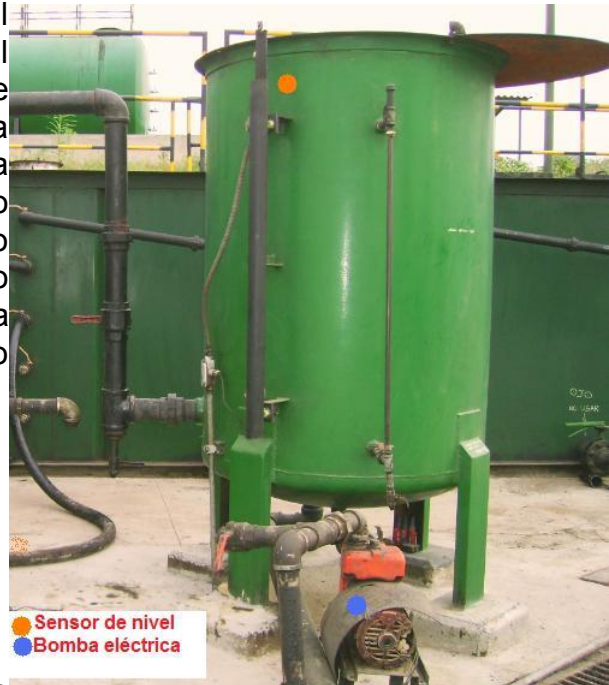
Figura 19. Sensores y actuadores para los tanques de bombeo
