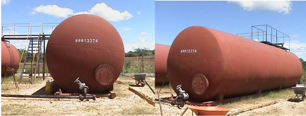
Figura 15. Tanques horizontales de almacenamiento de crudo
