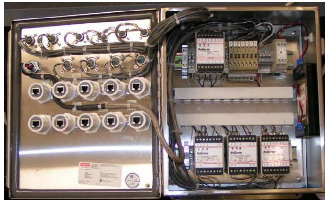
Foto de ACE Patch Panel Instalado en la Unidad
