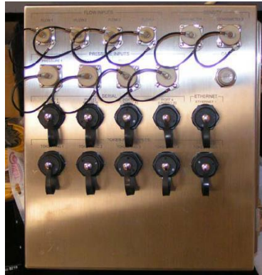
Foto de ACE Patch Panel Instalado en la Unidad
