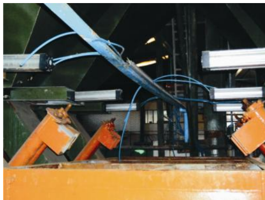
Figura 34. Salidas de las tolvas de almacenamiento
