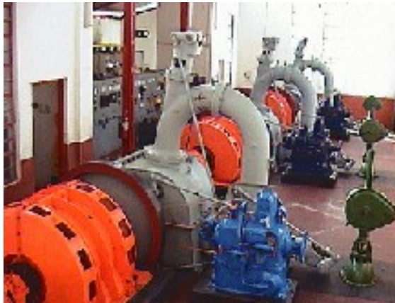
Figura 5. Central de Generación
