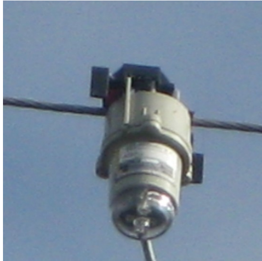
Figura 15. Indicador de Falla TST-OL en la Línea
