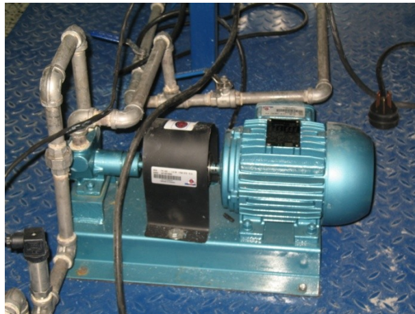
Figura 3. Sistema de bombeo (Viking Pump-Weg) implementado en el Banco
