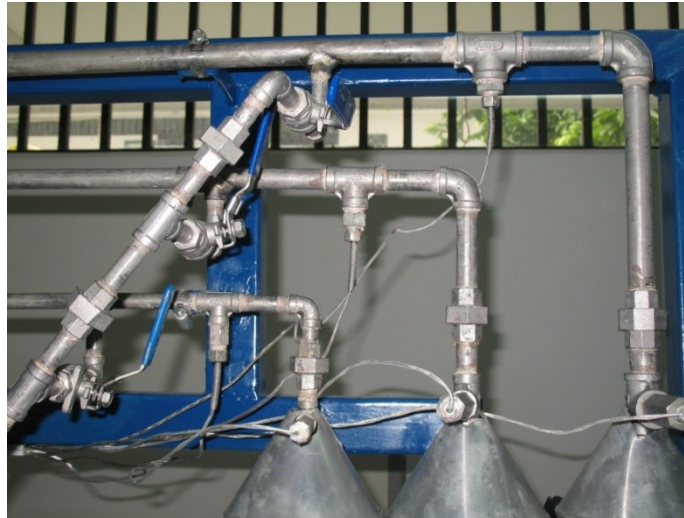
Figura 18. Sensores de temperatura (PT100) implementados en las tuberías del banco reológico de fluidos.
