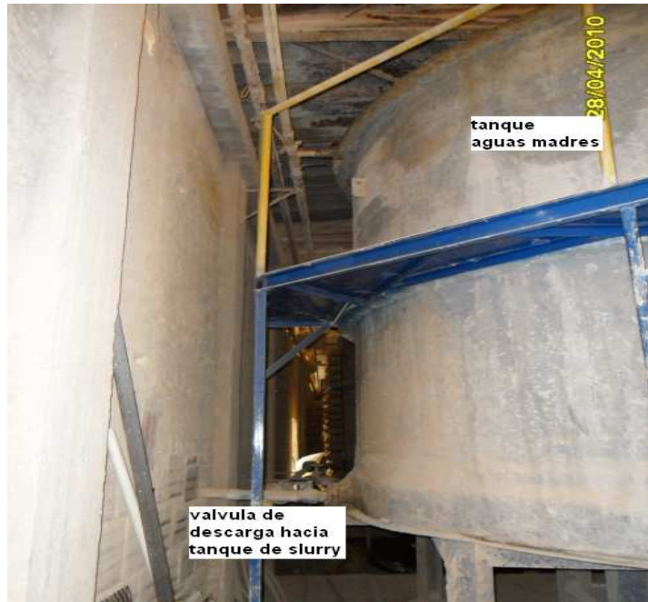
Foto 3 descarga de aguas madres a tanque de Slurry
