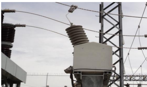
Figura 2. Transformador de tensión (PTs)
