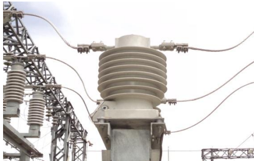
Figura 3. Transformador de corriente (CTs).
