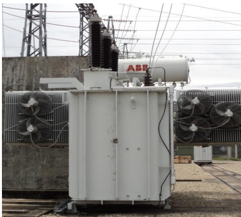
Figura 1. Transformador de potencia eléctrica.
