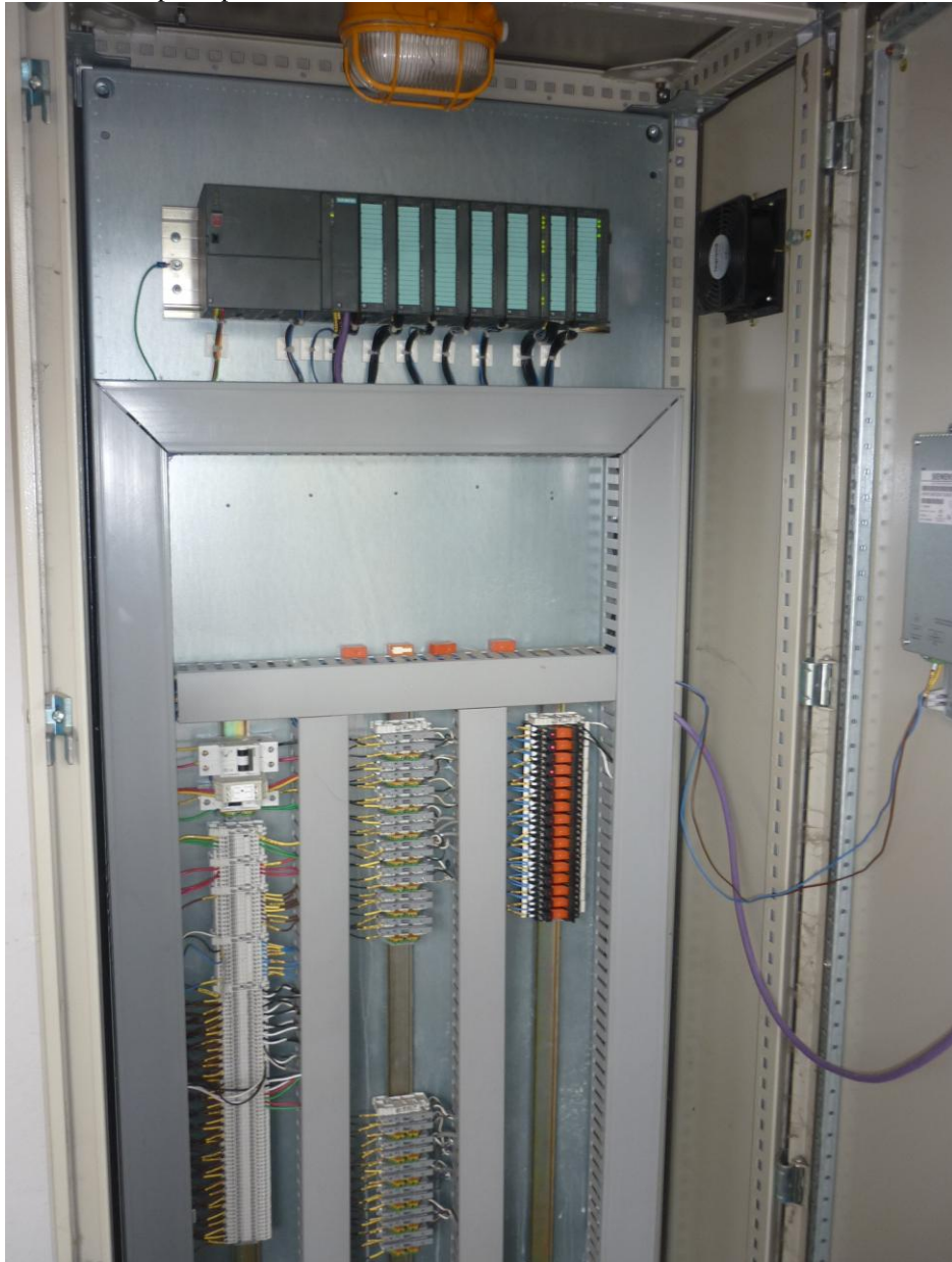
Figura 34. Rack estación principal.
