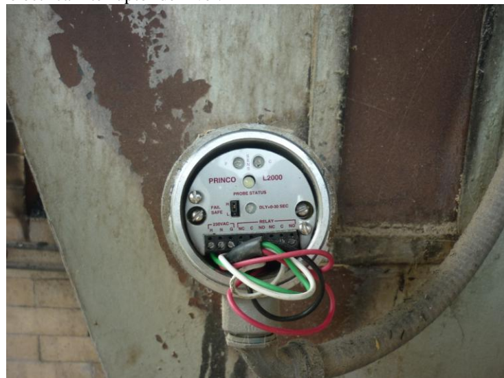
Figura 31: Conexión eléctrica interruptor de nivel.
