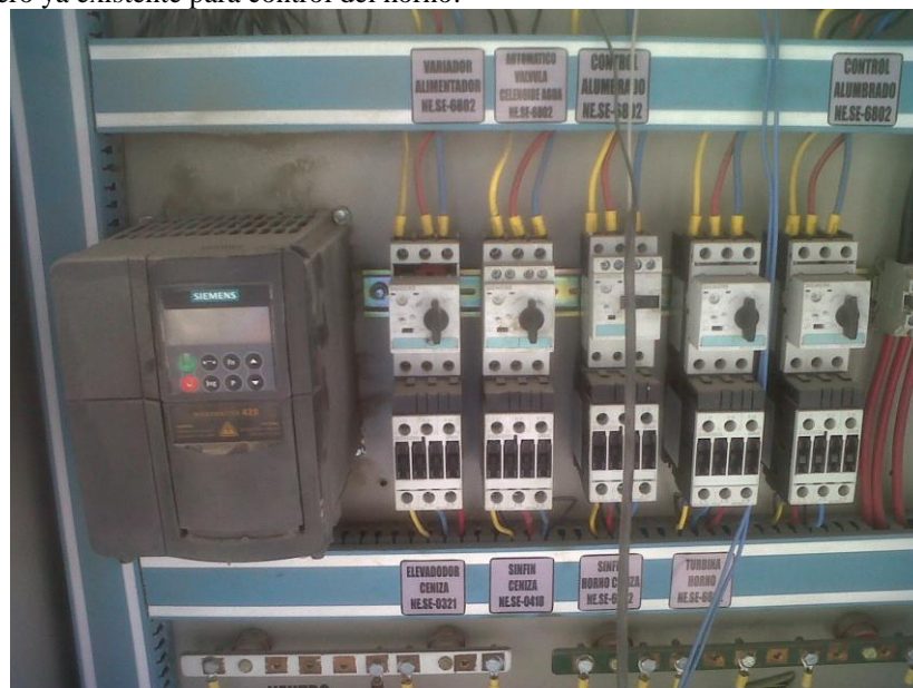
Figura 32: Tablero ya existente para control del horno.
