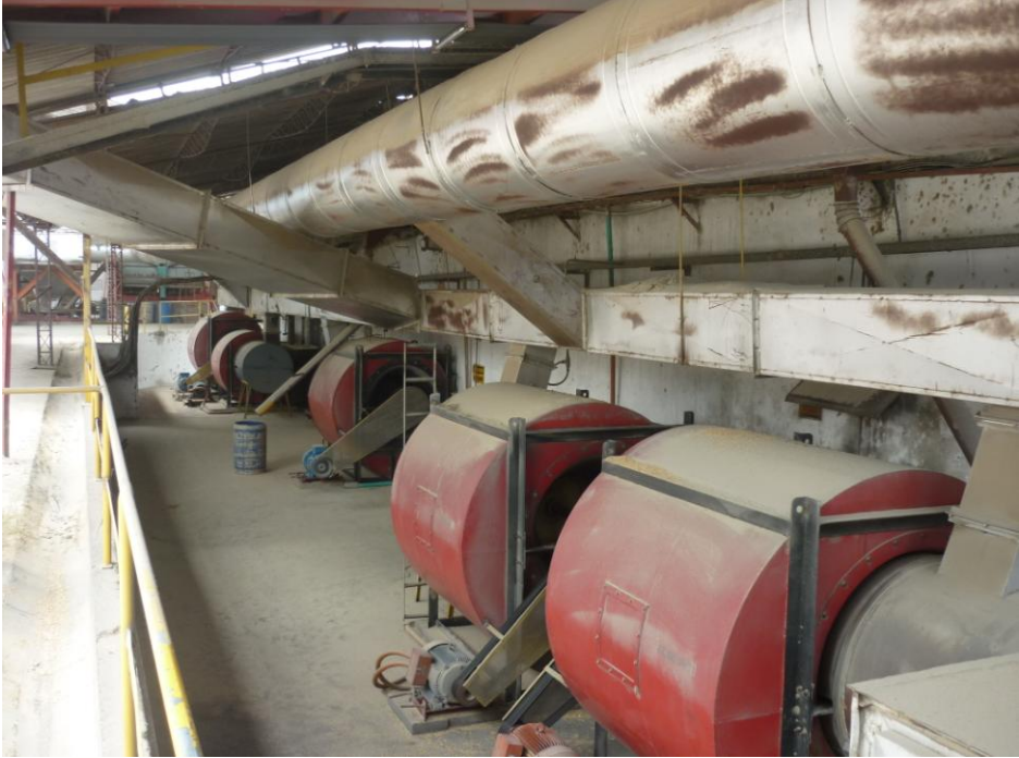
Figura 4. Ducteria de aire caliente.
