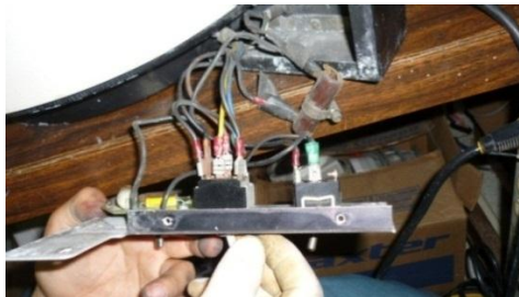
Figura 12. Vista interna del módulo de control analógico
