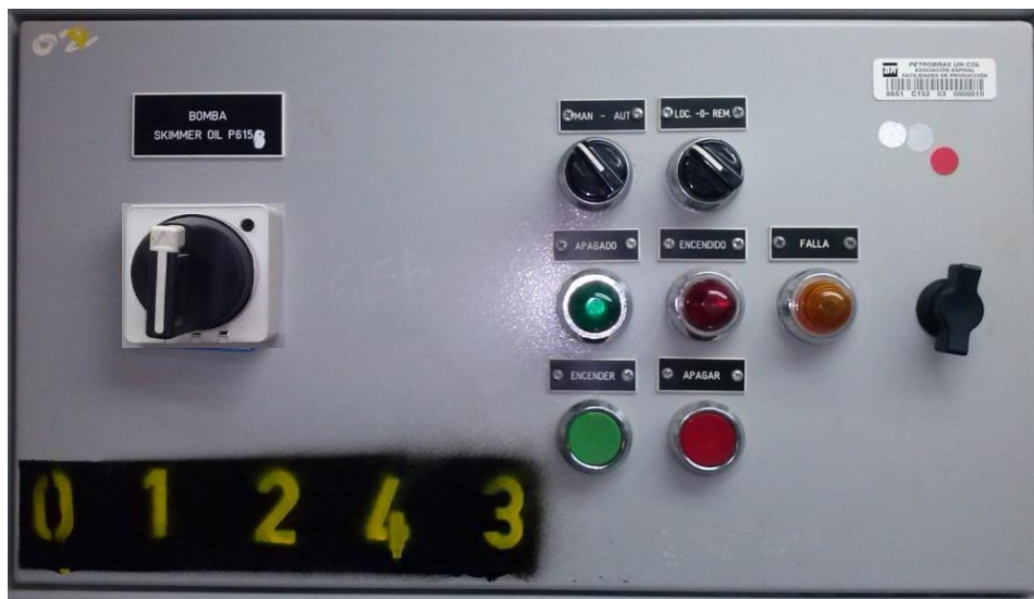
Figura 5. MCC bomba P-615B
