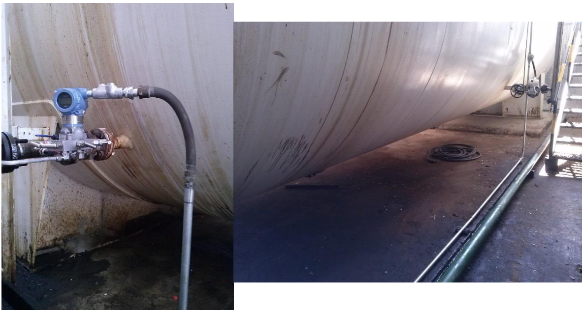
Figura 37. Instalación de facilidad para acometida eléctrica de transmisor Rosemount 3051CD en Skimmer V-615
