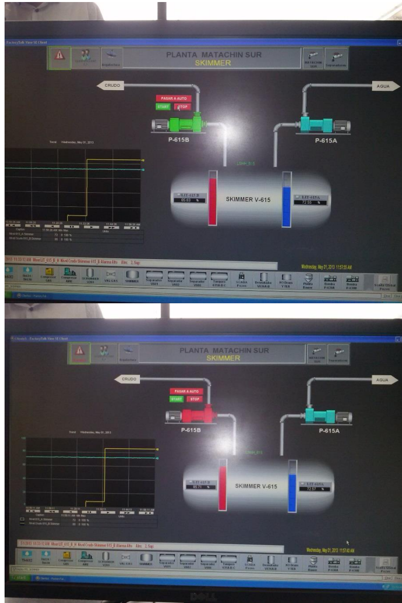
Figura 46. Prueba de funcionamiento en modo manual
