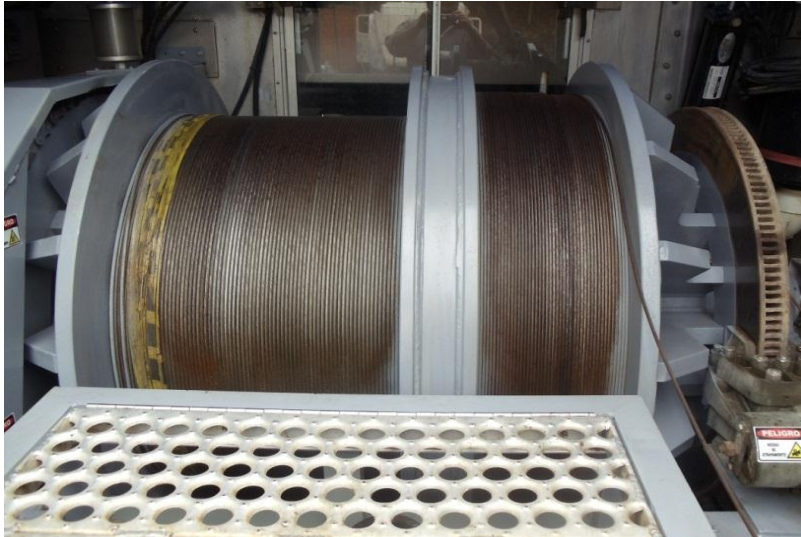
Figura 47: Carrete de cable 7/32 y 9/32 de unidad de registro
