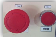
Figura 19. Pulsadores paro de emergencia y reset
