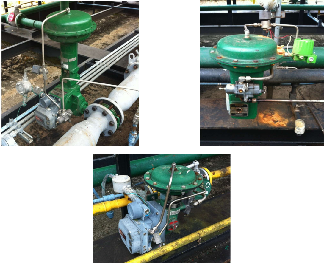
Figura 22. Válvulas de control en líneas de agua (izquierda), crudo (derecha) y gas (centro).
