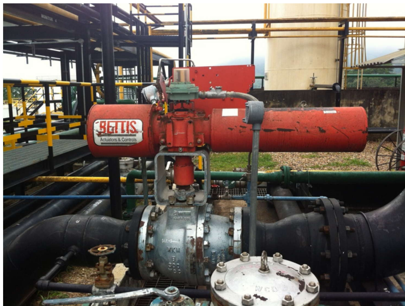
Figura 24. Válvula Shutdown o SDV
