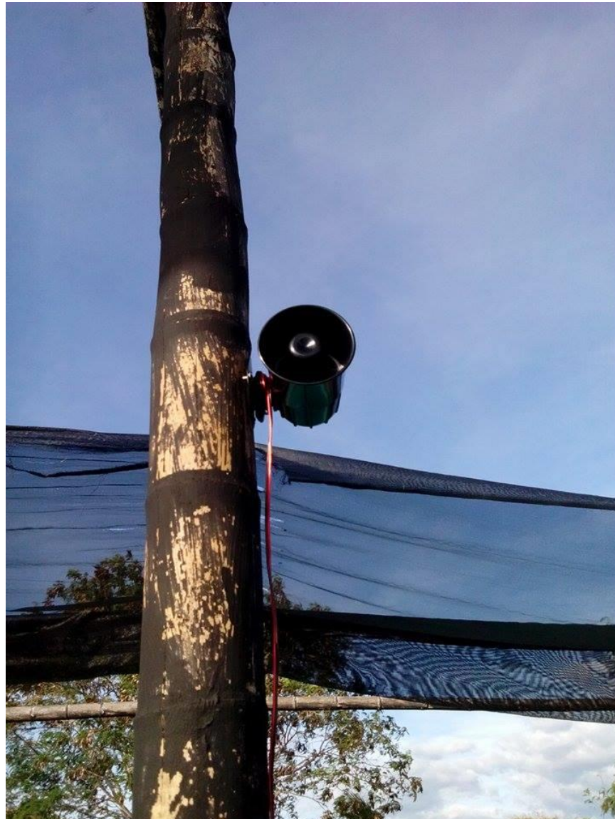
Figura 69. Sirena de alarma instalada
