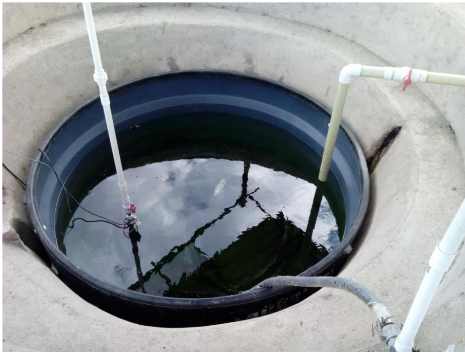
Figura 3. Bomba de agua sumergible (Granja Experimental-USCO)
