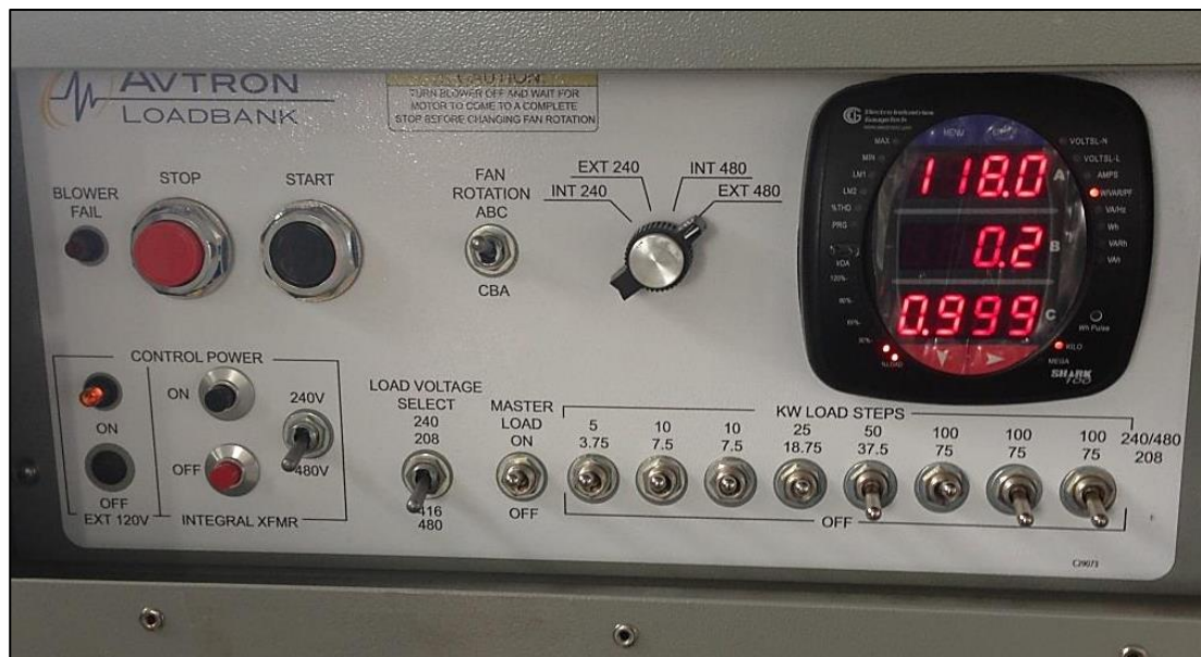
Figura 9.4 Tablero de Control de Banco de Carga Para Pruebas de VSD
