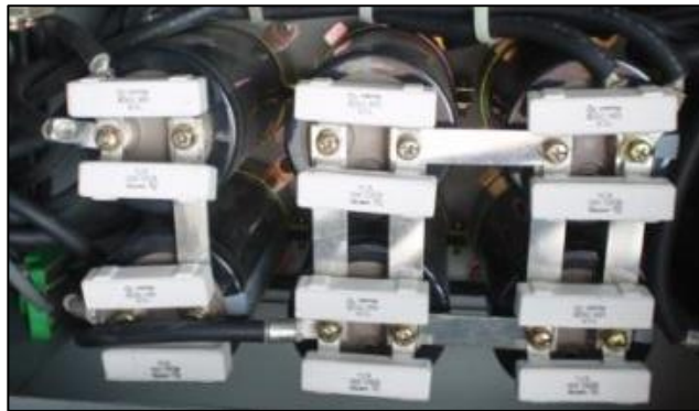
Figura 3.4 Banco de Condensadores de un VSD Schlumberger
