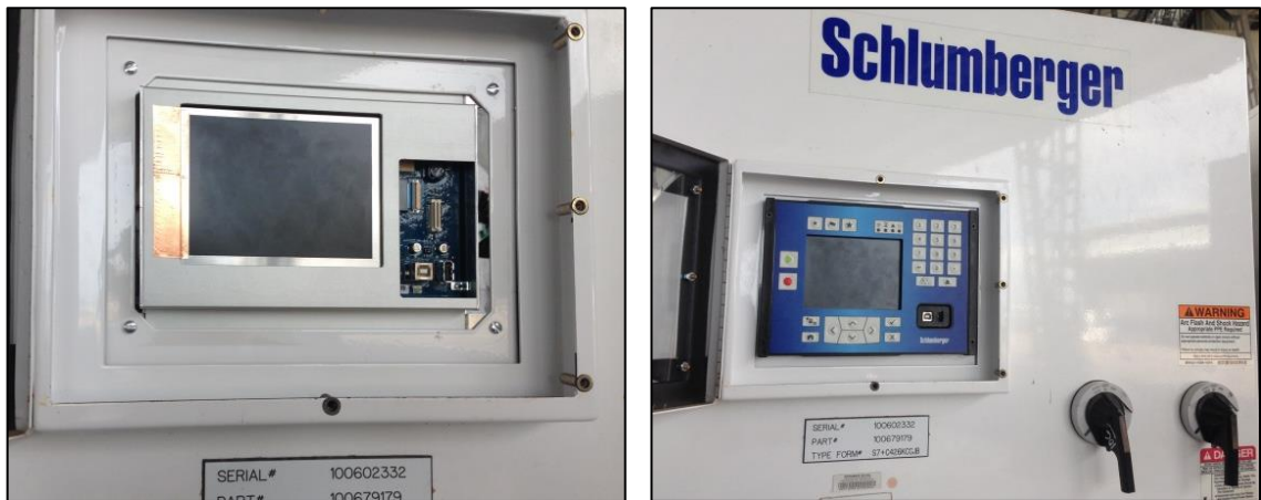
Figura 8.3 Adaptación Física de Controlador Instruct al Variador de Velocidad
