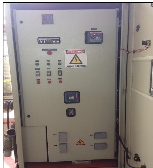
Figura 9.2 Tablero de Distribución para Energizar VSD
