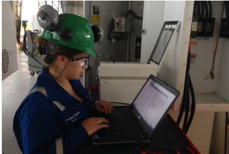
Figura 8.2 Trabajo con Instruct Conectado a Etapa de Control en VSD S7
