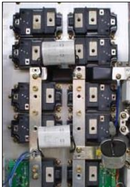
Figura 3.6 Sección Inversora de un Variador de Velocidad Schlumberger
