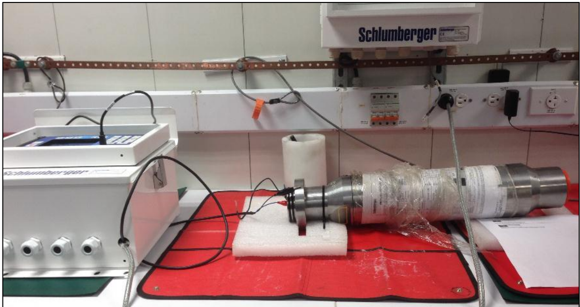
Figura 5.6 Pruebas de Comunicación Entre Controlador y Sensor
