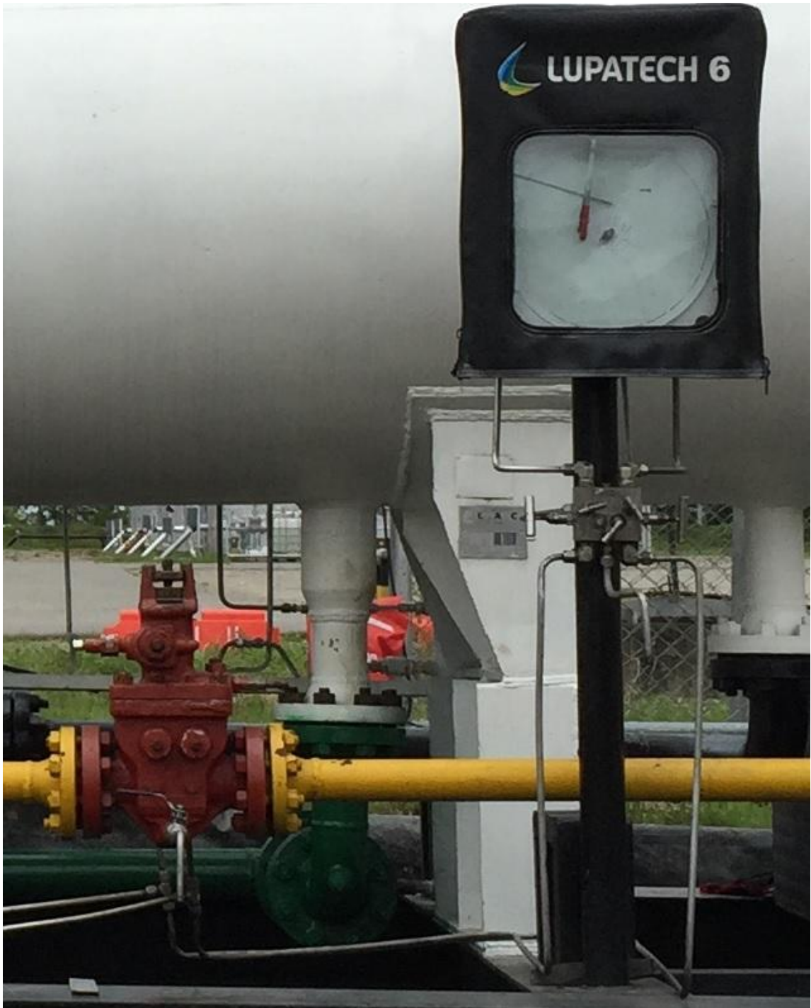
Figura 6. Registrador Barton y Medidor Daniel.
