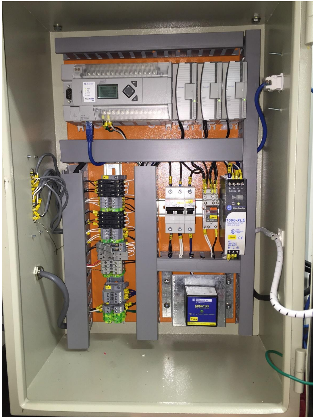
Figura 23. Tablero de distribución.
