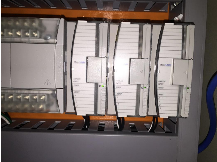
Figura 27. Módulos del PLC
