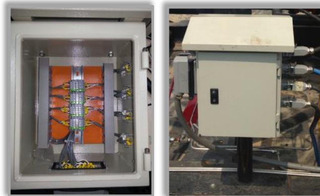
Caja de interconexión
