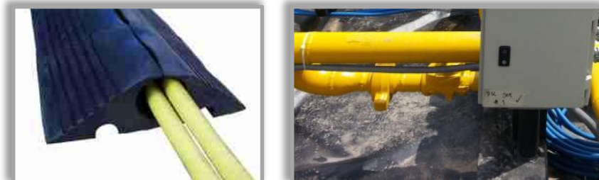
Línea de 24 hilos protegida
